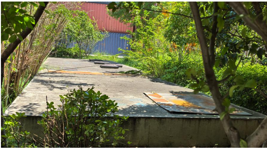
一体化污水处理设施（前）及生活污水调节池（后）
