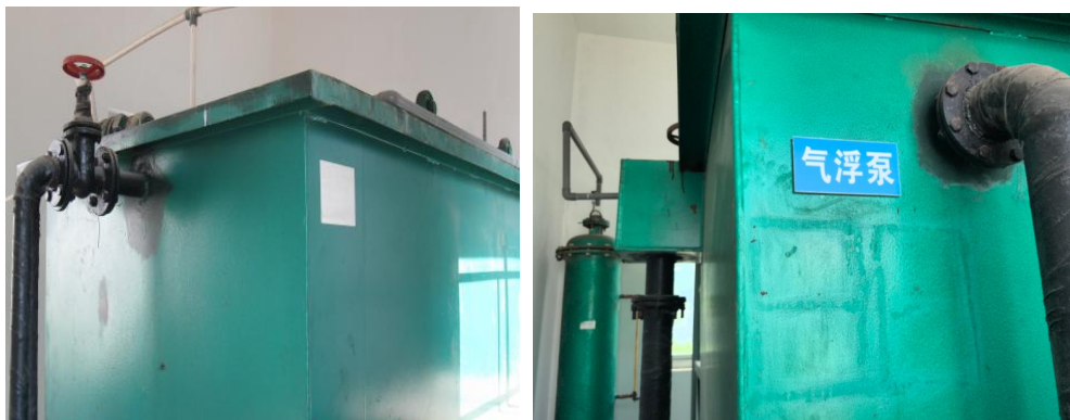
气浮装置（位于污水处理设备间内）
