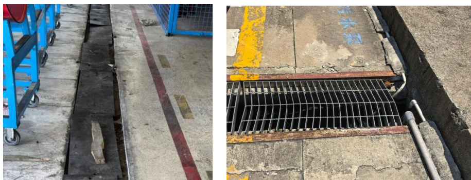
机修含油污水排水沟
